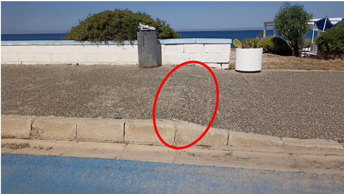
Figura 2 Stato di fatto marciapiede (rigonfiamento)
