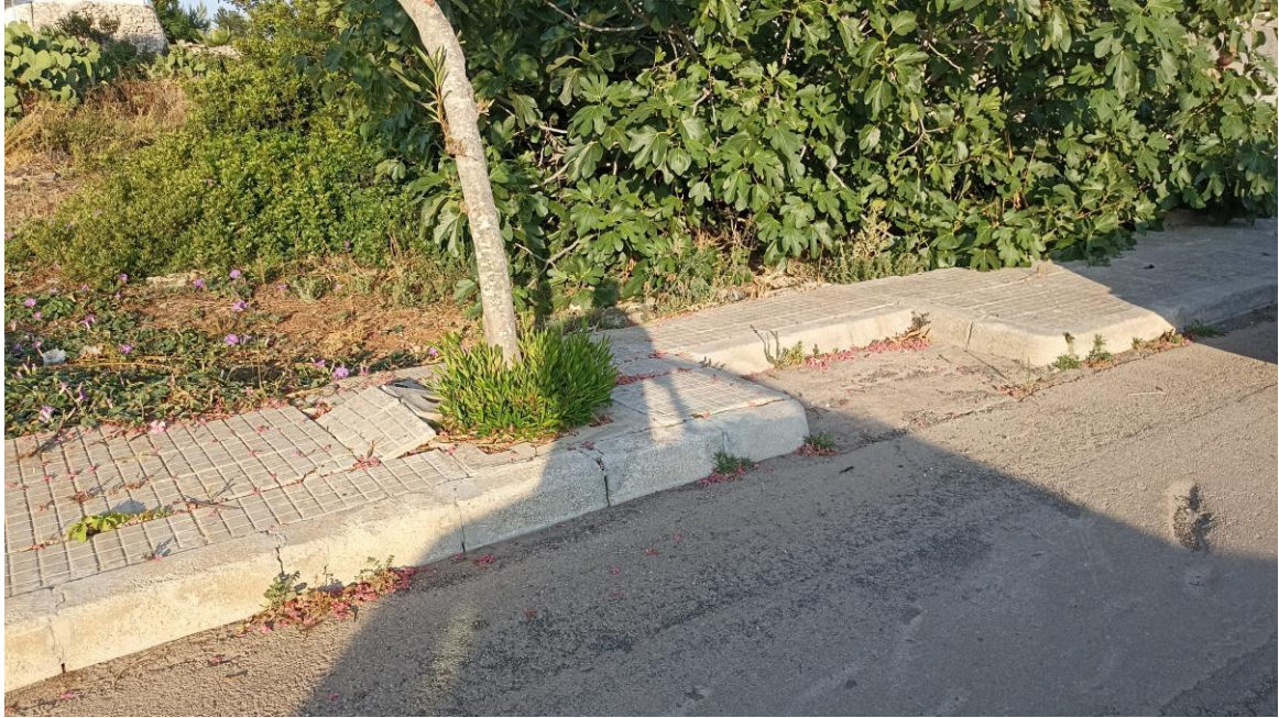
Figura 16 Stato di fatto marciapiede Via Adua
