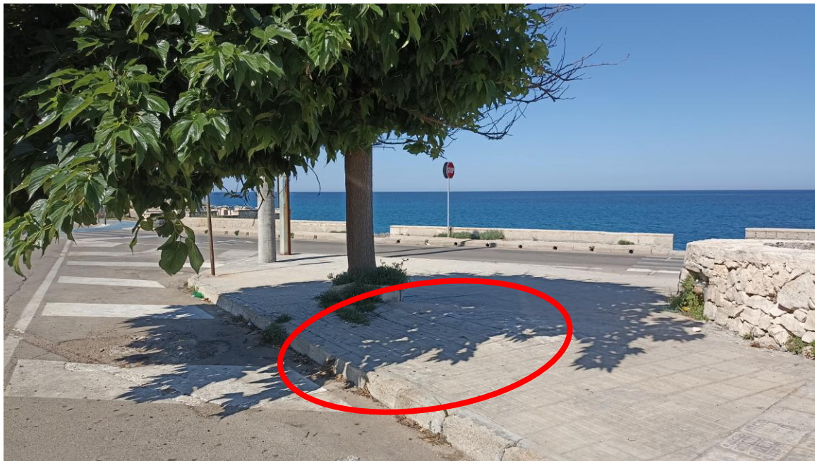
Figura 13 Stato di fatto marciapiede Piazza Stella Maris
