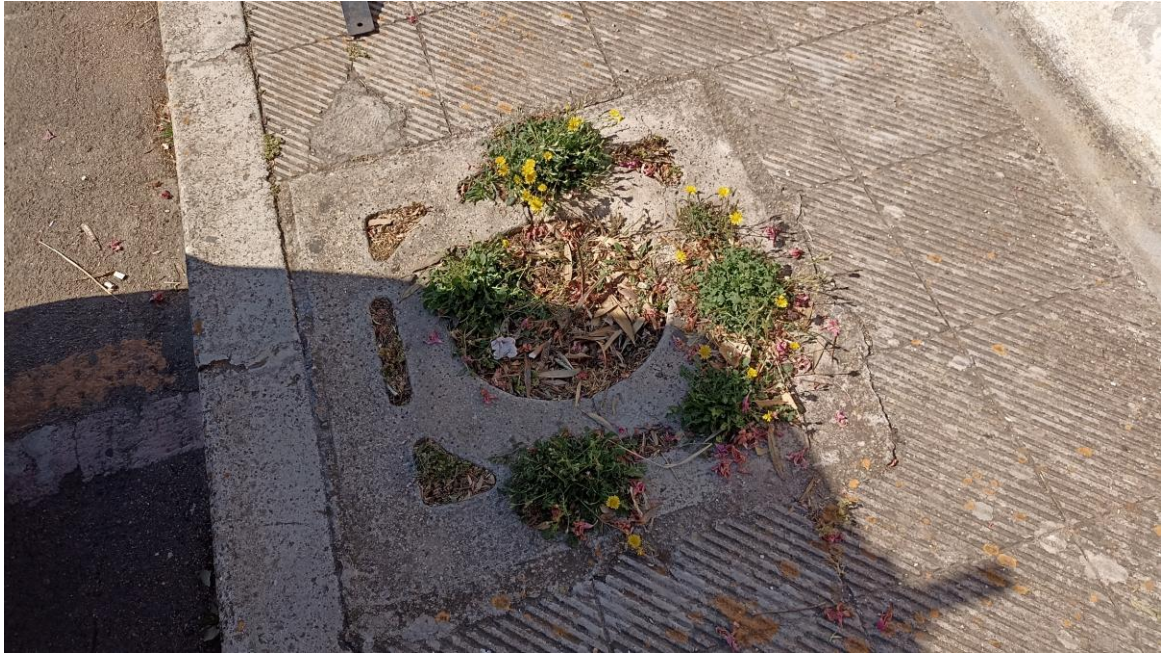
Figura 10 Stato di fatto marciapiedi Via Marco Polo
