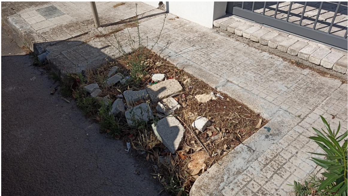
Figura 11 Stato di fatto marciapiedi Via Marco Polo
