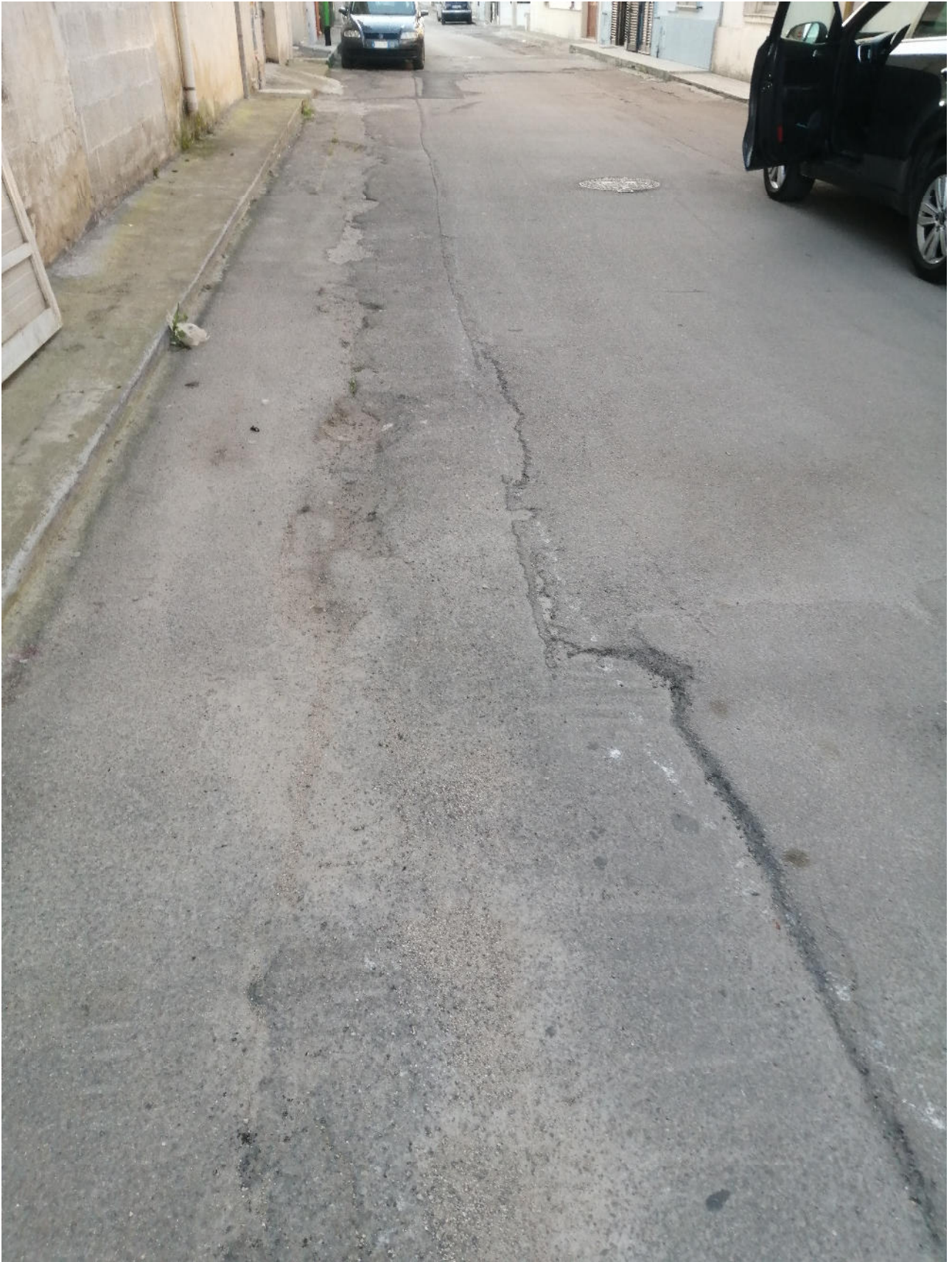
Figura n. 26 via Martiri di Marcinelle ID 13
