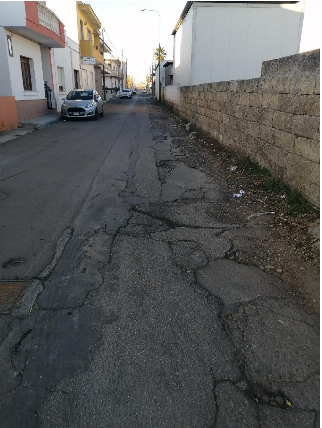
Figura 12via Cagliari ID 5
