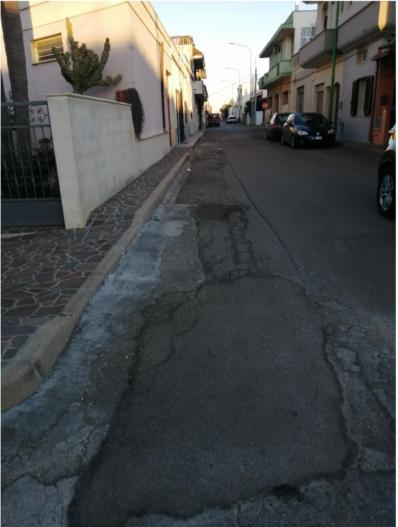
Figura n. 27 via Martiri di Marcinelle ID 13
