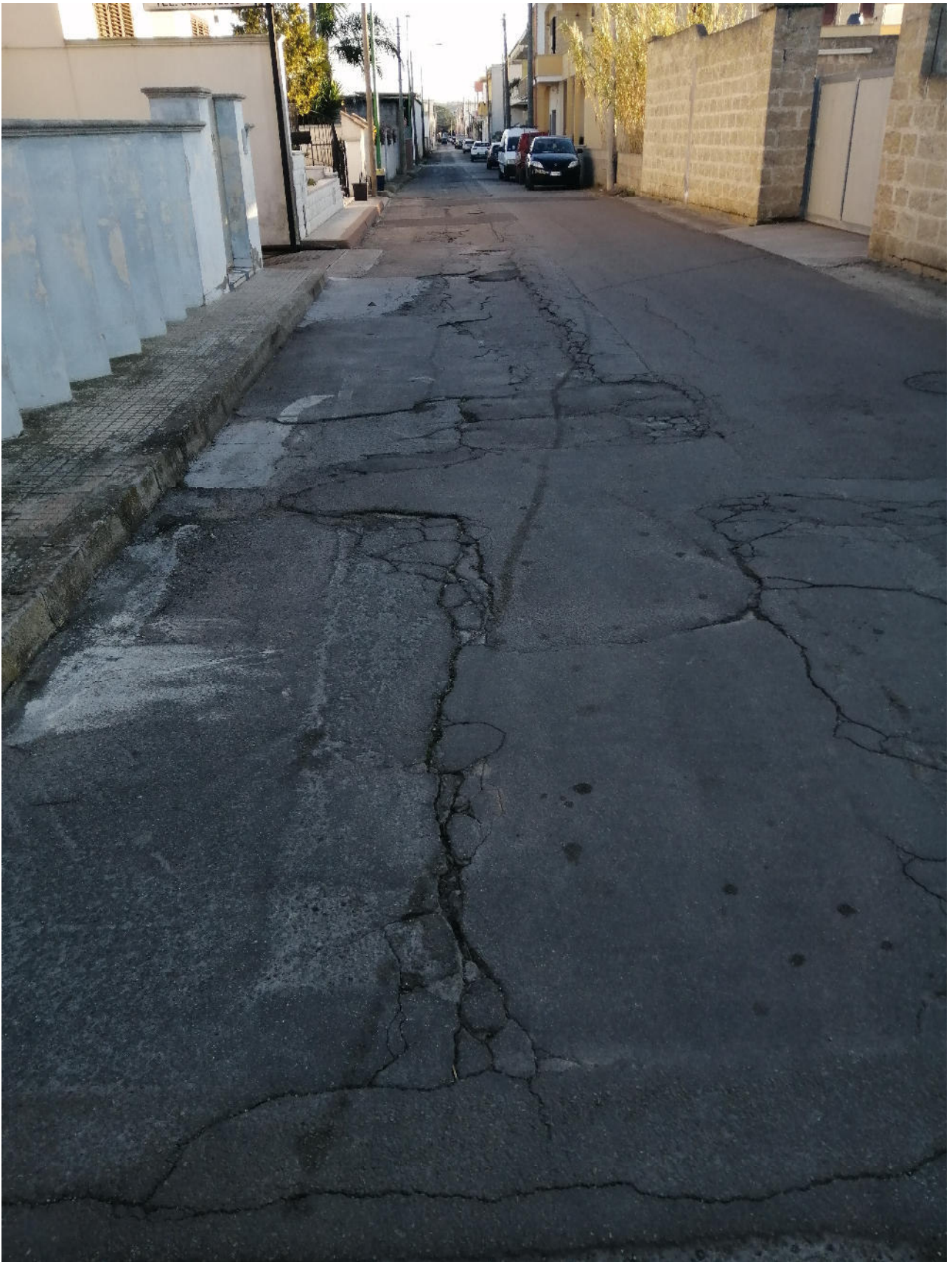
Figura 11 via Cagliari ID 5
