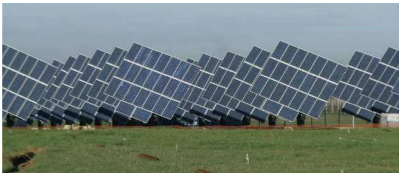
Impianto fotovoltaico in località "Vignali"
